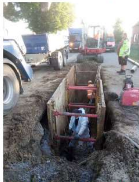
Rohrbruch in Wadersloh, Glennestraße, im Juni 2022.
